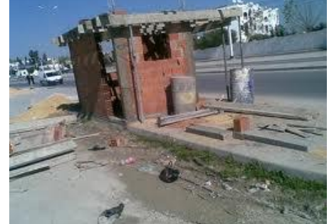
تجنب البناء الفوضوي
